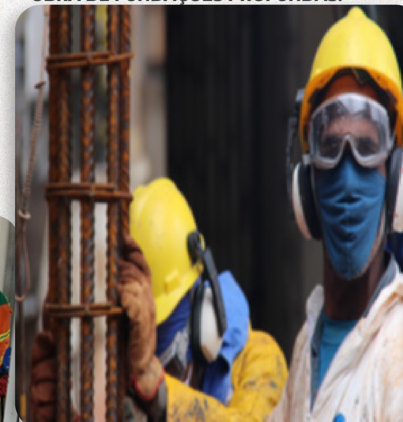
FONTE: IMAGEM DE EXECUÇÃO DE FUNDAÇÕES PROFUNDAS EM SALVADOR-BA EQUIPE DE SEGURANÇA DO TRABALHO.
