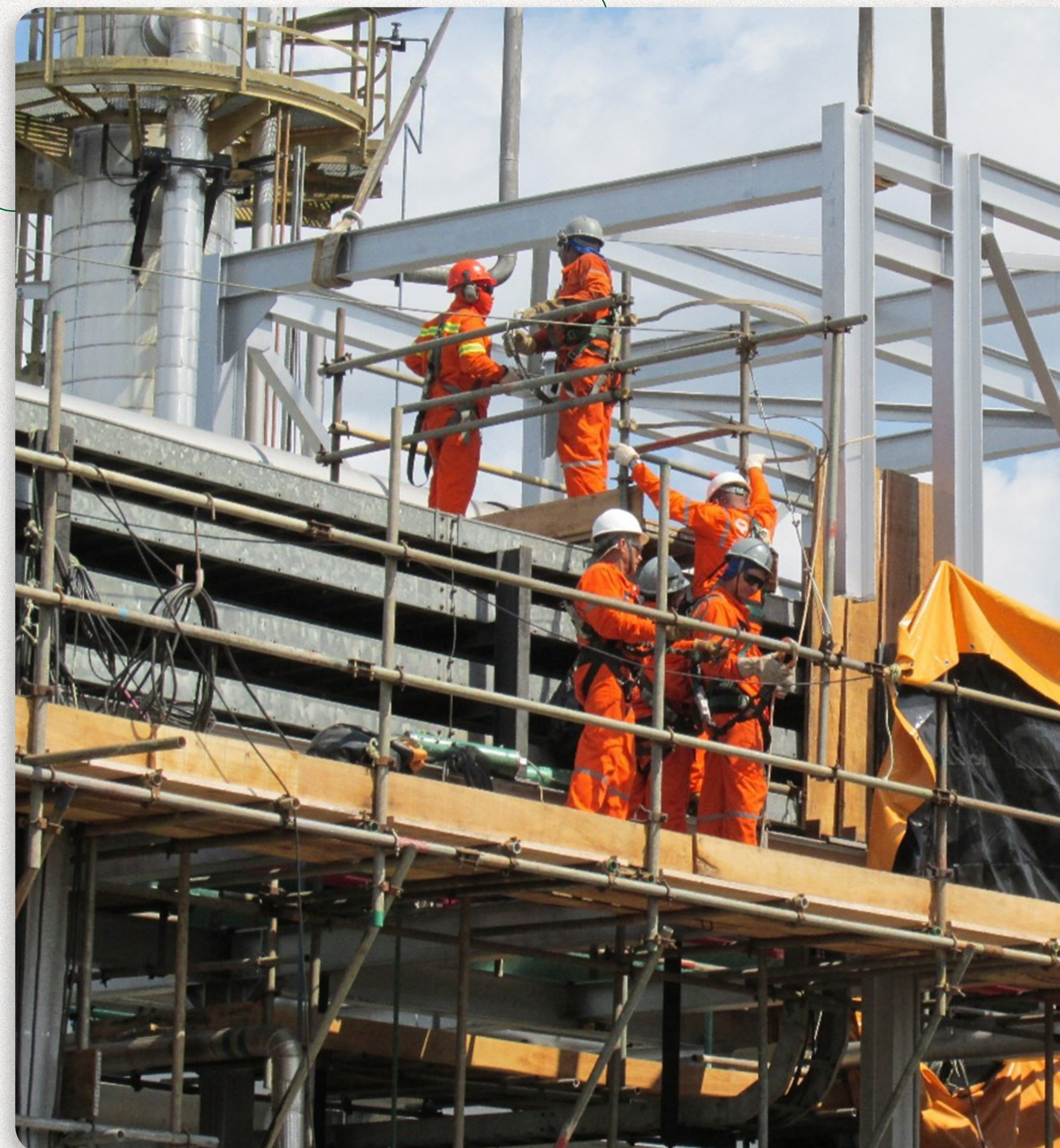
FONTE: IMAGEM DE EXECUÇÃO DE OBRA DE FUNDAÇÕES PROFUNDAS. EQUIPE DE ENGENHARIA.
